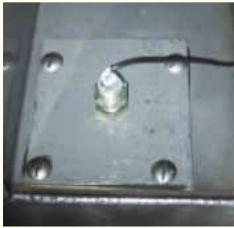
Kontrolllucka / tank med varningssystem för vattennivå.
